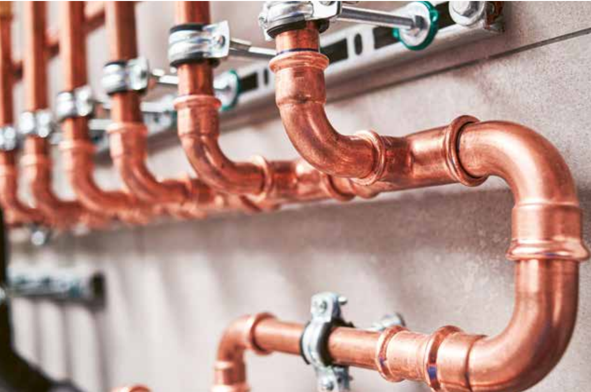
Im Bild Zwischen 35 °C bis 40 °C können sich Legionellen in den Leitungen der Hausinstallation vermehren.
