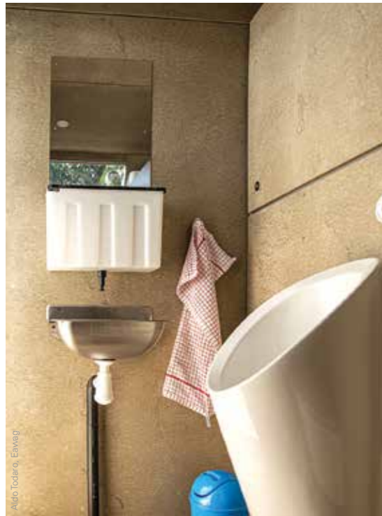
Steht einer «normalen» Toilette in Sachen Komfort in nichts nach: Das Autarky-WC-Häuschen mit Trenntoilette (nicht im Bild), Pissoir und Waschbecken.
