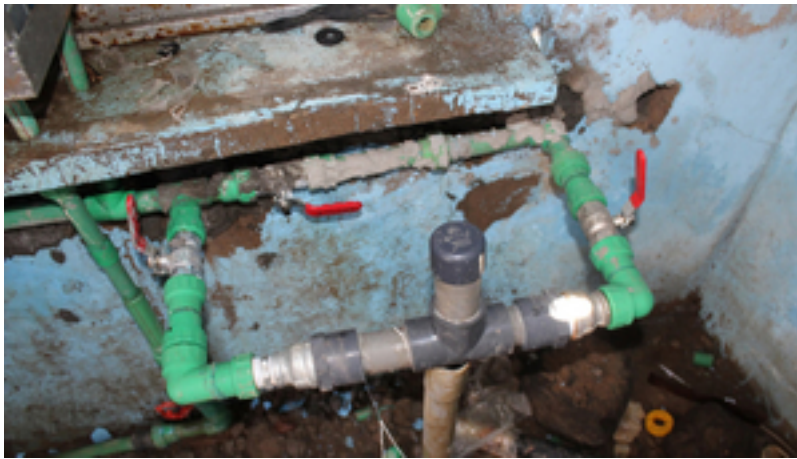
Passive, lokal hergestellte Chlorierungsanlage, die in einem Wasserkiosk in Kenia installiert wurde. (Foto: Lisa Appavou)
