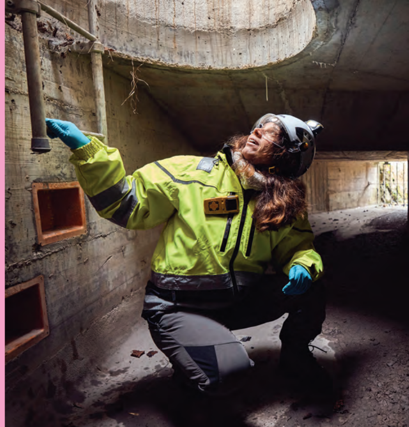
Le laboratoire de terrain d'hydrologie urbaine permet d'étudier les questions émergentes concernant le développement des infrastructures d'adduction et d'évacuation des eaux. (Photo: Christian Grund/13Photoa)
