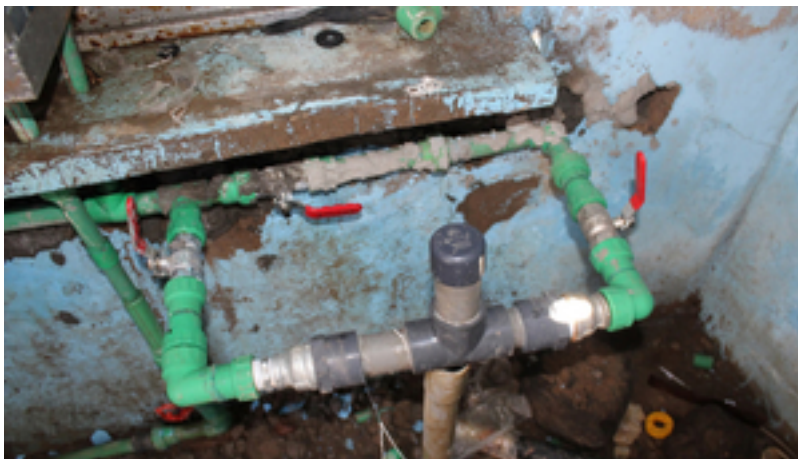
Système de chloration passif, fabriqué localement, installé dans un kiosque à eau au Kenya. (Photo: Lisa Appavou)
