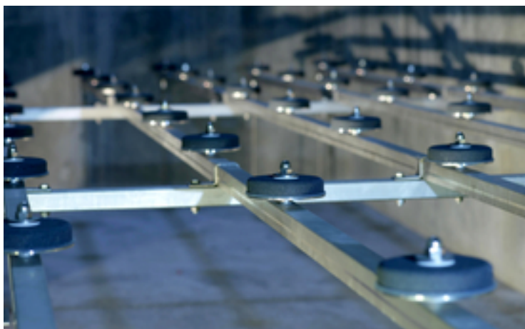
L'ozonation est une méthode éprouvée pour éliminer les composés traces organiques de l'eau. Sur la photo: des diffuseurs d'ozone à la STEP Neugut de Dübendorf. (Photo: Aldo Todaro, Eawag)
