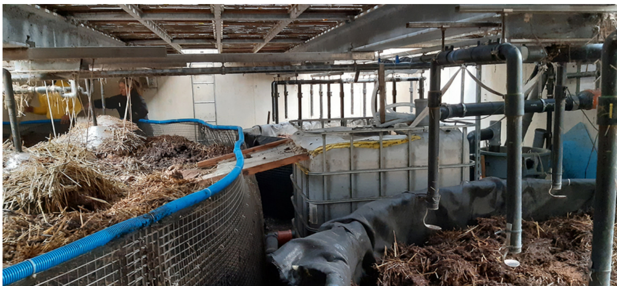
Installation d'un vermifiltre à la coopérative d'habitation Équilibre à Genève (Photo: Eawag, Kayla Coppens).
