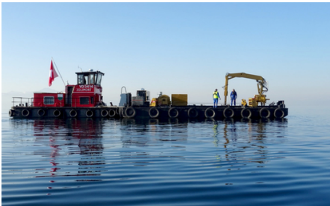
Travaux lors de l'installation de la plateforme sur le lac Léman ( Images : Natacha Pasche, le 18 février 2019 et 19 février 2019 )
