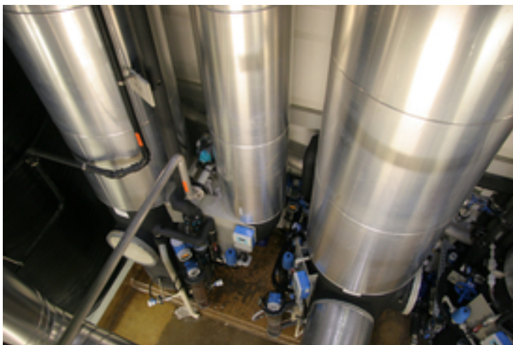
Installation de strippage à l'air servant à la récupération de l'azote dans la station d'épuration d'Opfikon.
