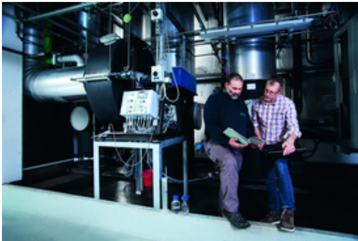
Installation de stripping à l'air servant à la récupération de l'azote dans la station d'épuration d'Opfikon.
