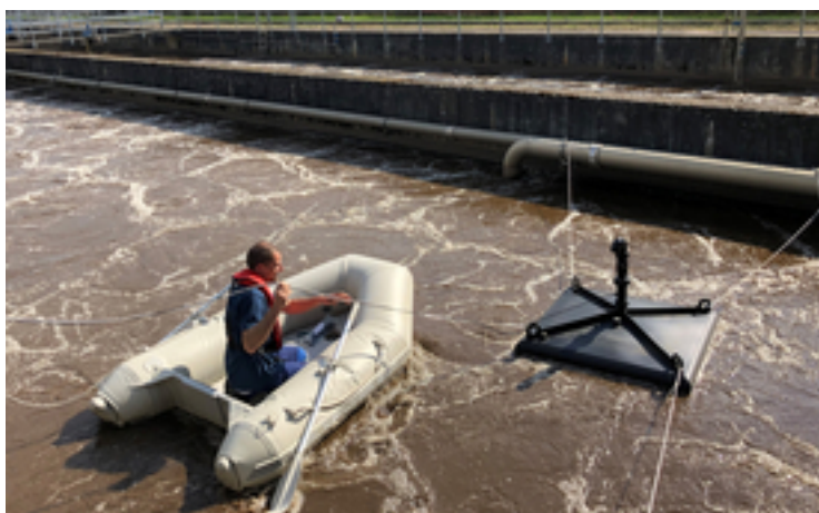
Le chercheur de l'Eawag, Wenzel Gruber lors de travaux de maintenance du dispositif de mesure de la STEP Moossee Urtenenbach. (Photo: Andrin Moosmann)
