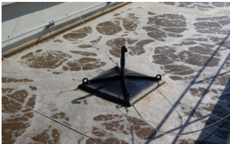
Hotte de mesure des effluents gazeux en service à la STEP de Birs. (Photo: Andrin Moosmann)
